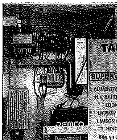
Armoire de commande
